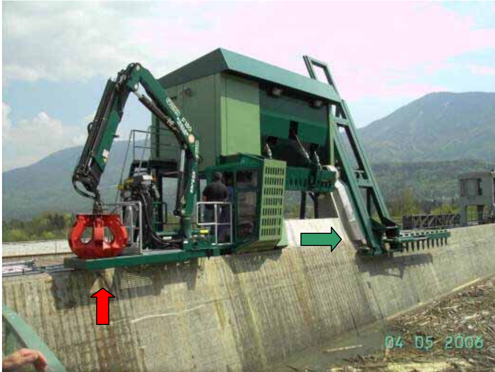
Bild 9: Seil-Rechenreinigungsmaschine (KW Feistritz)
